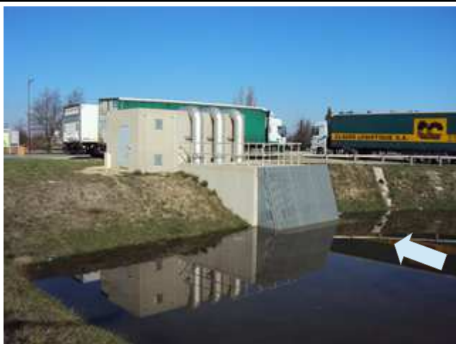
Photo N° 7 Abords entrée Nord ZAC du Plan – Station de pompage
